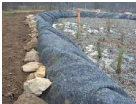
Koreňová čistička odpadových vôd tesne po osadení ešte nepracuje na sto percent, ale ako rastlinky dorastajú, zvyšuje sa aj jej výkon. (foto: Kořenovky.cz)
